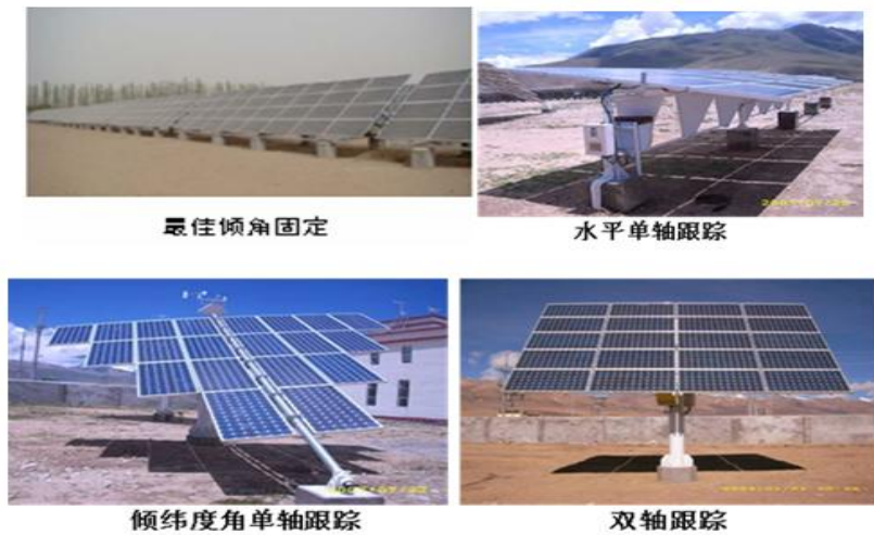
图5.2-1 不同运行方式的光伏电站现场图片
