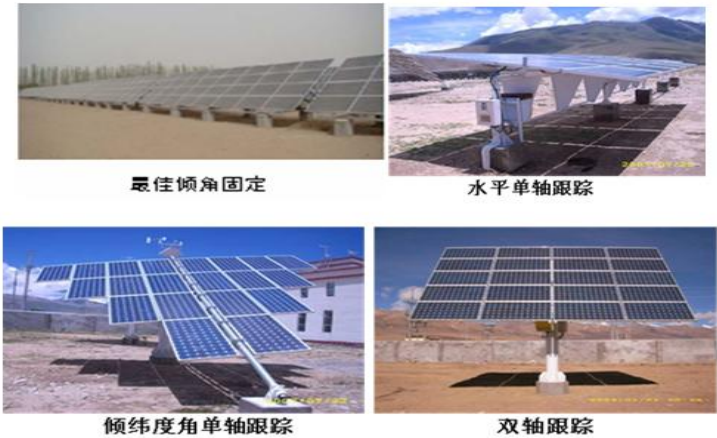
图5.2-1 不同运行方式的光伏电站现场图片
