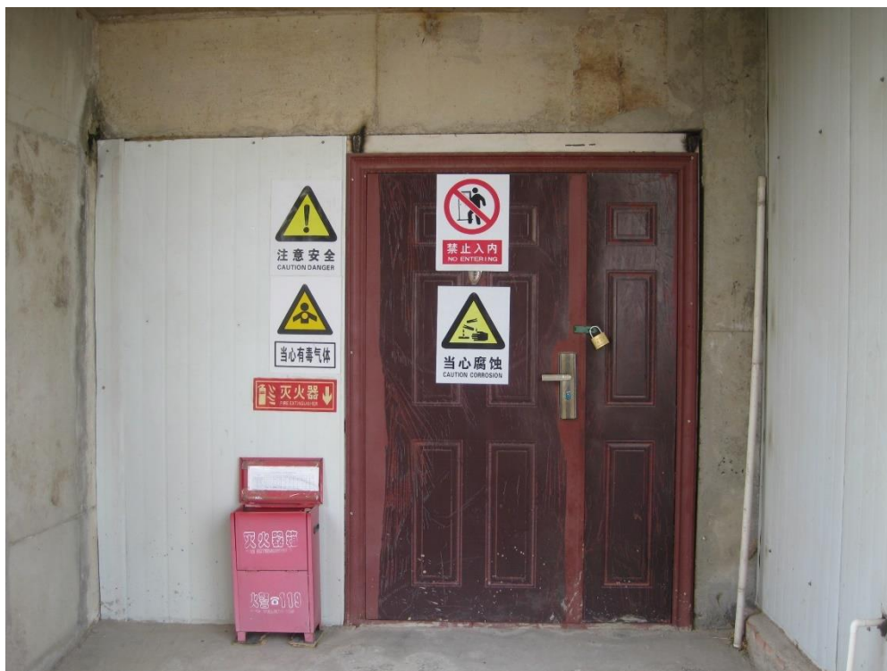
Figure 10: 五里坨污水处理厂化学品储存间
